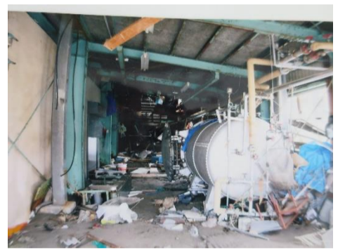
▲本社工場は津波で流失した。
